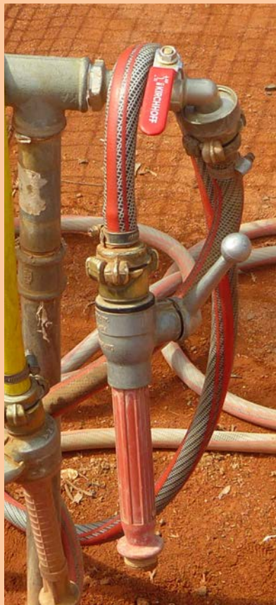
Schlauchdüse geschlossen auf dem Wasserrohr liegend
